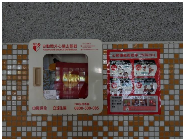
場館備有 AED 設備
